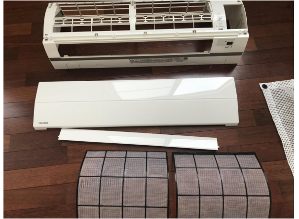
1.エアコンクリーニング
