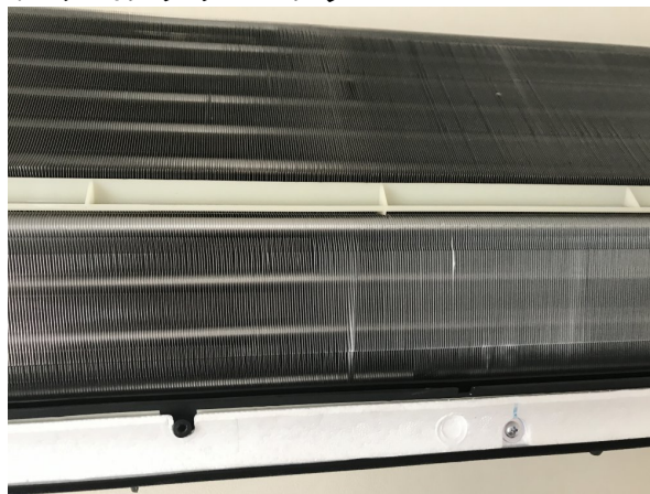
1.エアコンクリーニング
