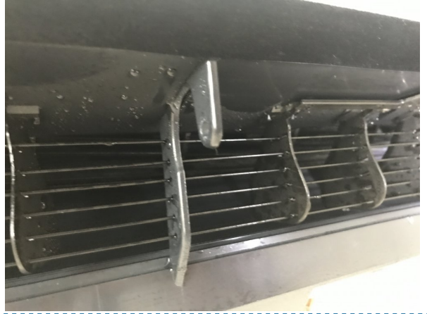
1.エアコンクリーニング
